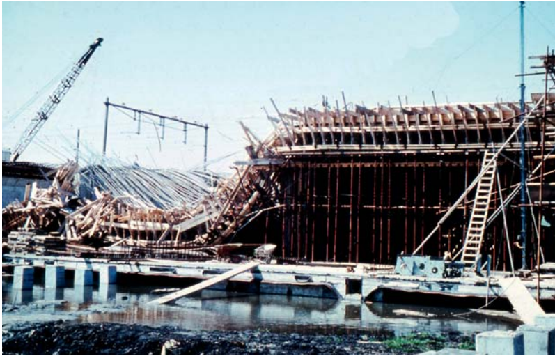
FIGUUR 1.3 Toelaatbare sterkte overschreden, bezwiken betonbekisting
