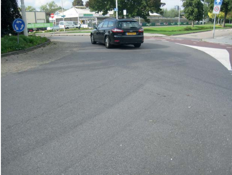
FIGUUR 1.4 Viskeuze vervorming in asfalt door verkeersbelasting
